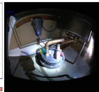
圖 10 未受影響設備-排水管-熱點判斷
