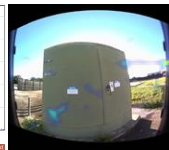
圖 24 未受影響設備-大型變壓器-熱點位置
